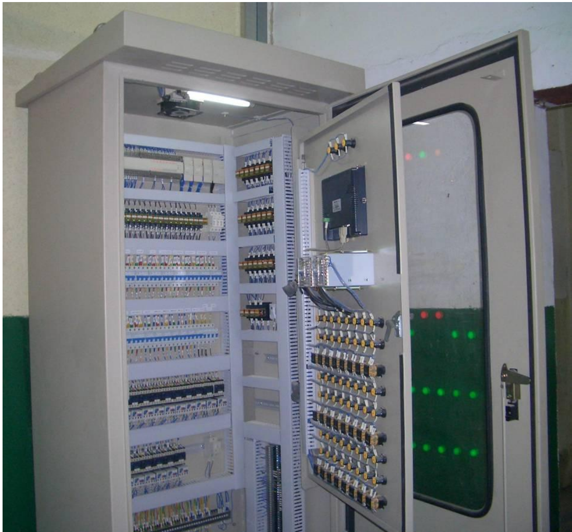
CABINA DE CONTROL
